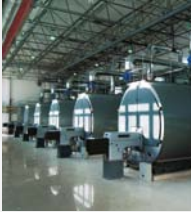
Moderne Industriefeuerungen Modern industry firings
